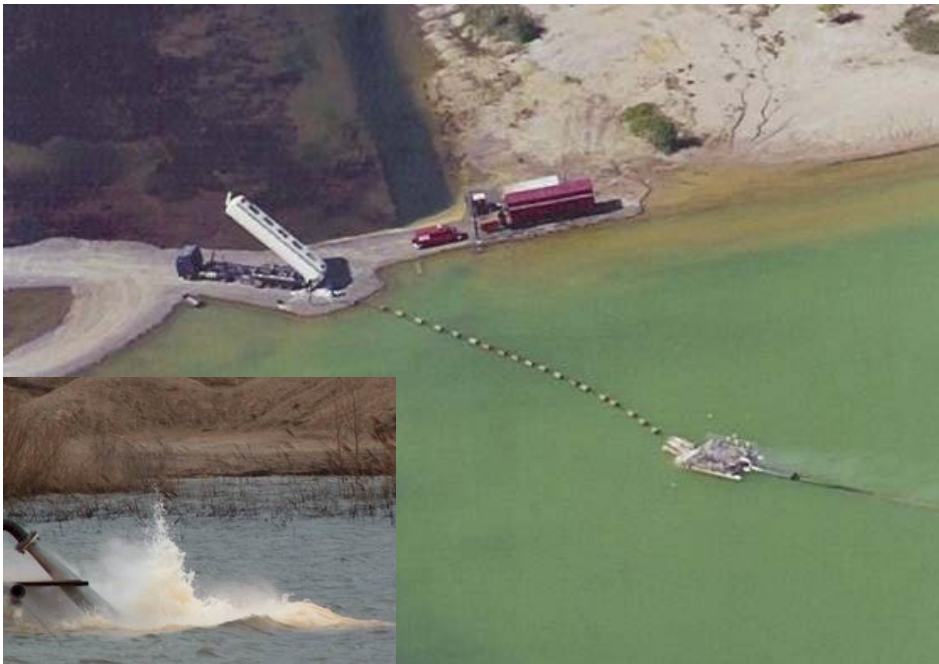
Abb. 5: Soda-Eintrag in den Bockwitzer See (Quelle: BGD/LMBV)
